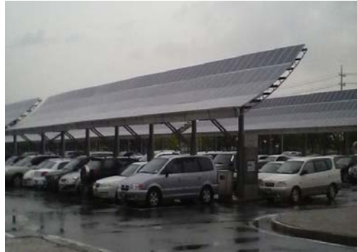
〈그림 5〉 주차장에 설치된 태양광 설비
